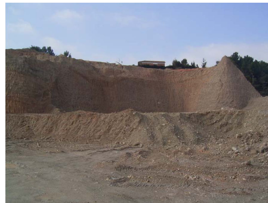
Construcció amenaçada per una explotació d'àrids, amb talussos molt verticals i precaris
